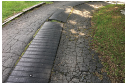
カート路劣化による路盤ひび割れと沈み込み
