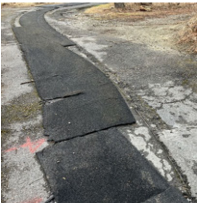
カート路劣化による誘導線の露出
